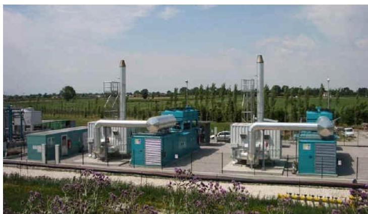
L'impianto di valorizzazione del biogas presso la discarica di Jesolo
