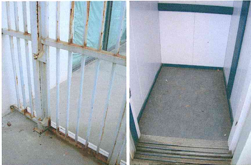
Stato manutentivo su cancellata 1 piano, stato ascensore
